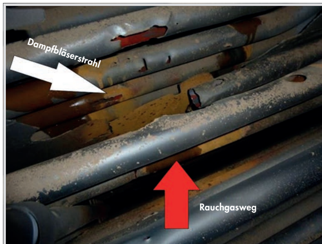
Bild 3. Geschädigte Wärmetauscherrohre im Zwischenüberhitzer 1 mit Medienwegen.
