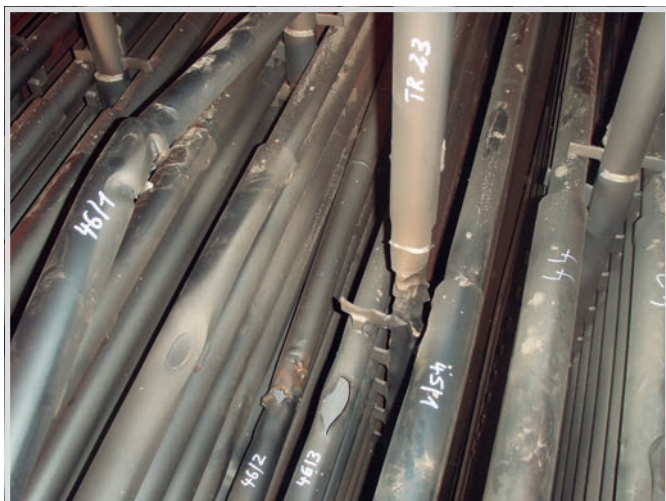
Bild 2. Geschädigte Wärmetauscherrohre im Zwischenüberhitzer 1.
